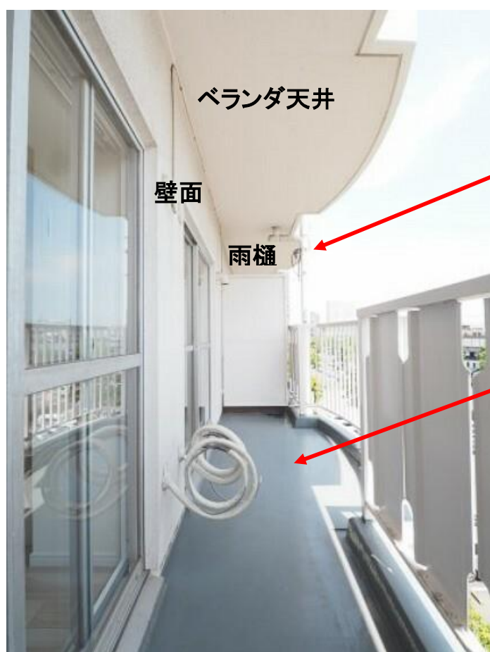
雨樋から水が漏れる
