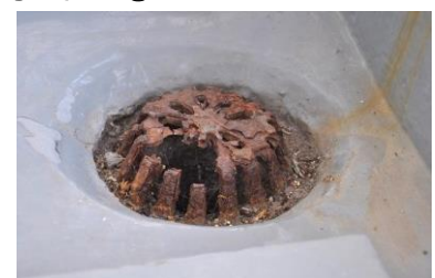
ドレンが破損している
