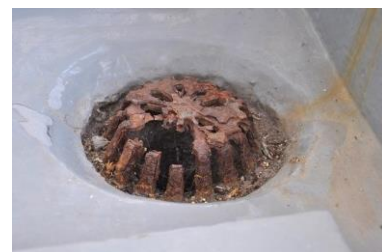
ドレンが破損している
