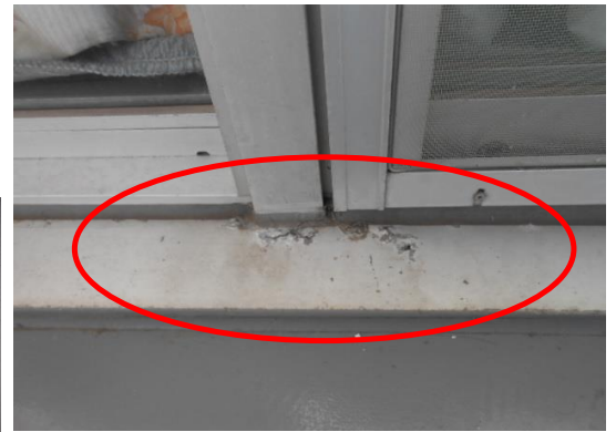
皿板の表面に傷みがある
