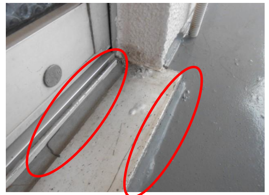
皿板周りのシーリング材に傷みがある
